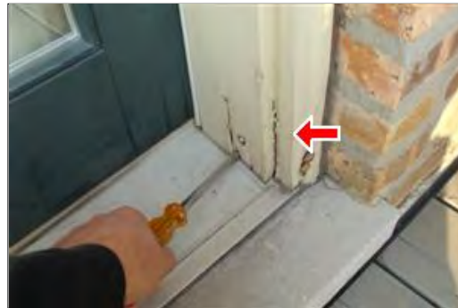
K. Picture 12 Rot at Door Jamb
