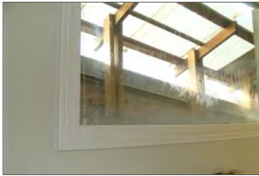
K. Picture 14 Blown Thermal Seal
